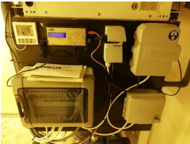
Fig. 2.4. DimLux™ MaxiController in de teeltruimte (container) die het lichtregime regelt.
